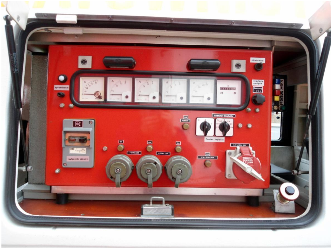
Agregat prądotwórczy trójfazowy
